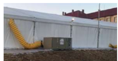
Klima und Belüftung
